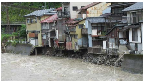
2021年8月豪雨による木曽川沿いの住宅被害(木曽町)
